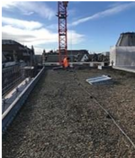
Foto: Grind op het dak
